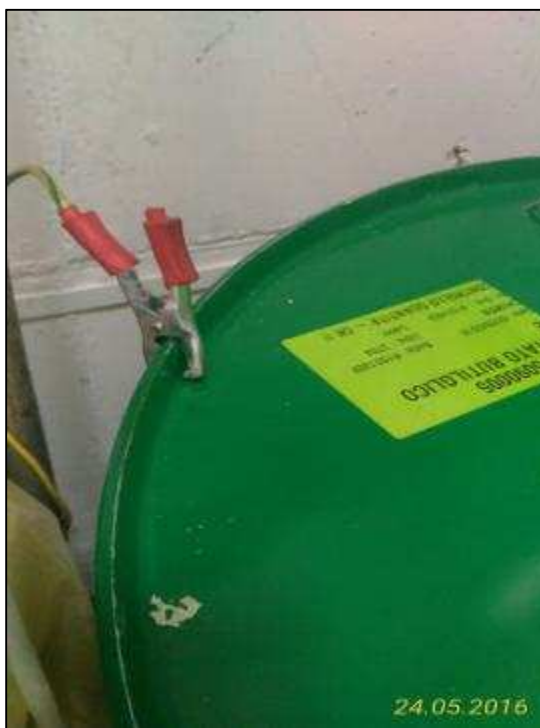
Pinza deformata e non correttamente connessa
